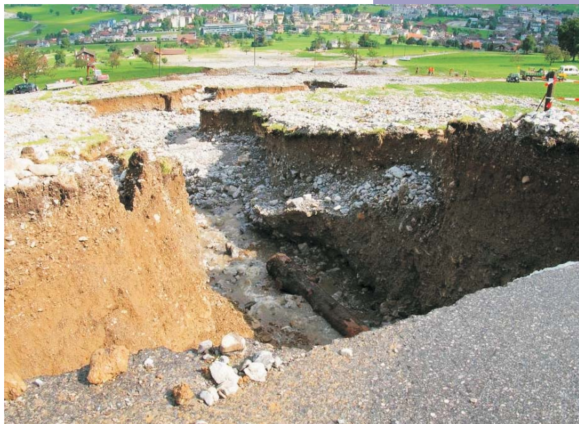
Kniri West: Massive Auskolkung unterhalb der Strasse. (Bild oq)
