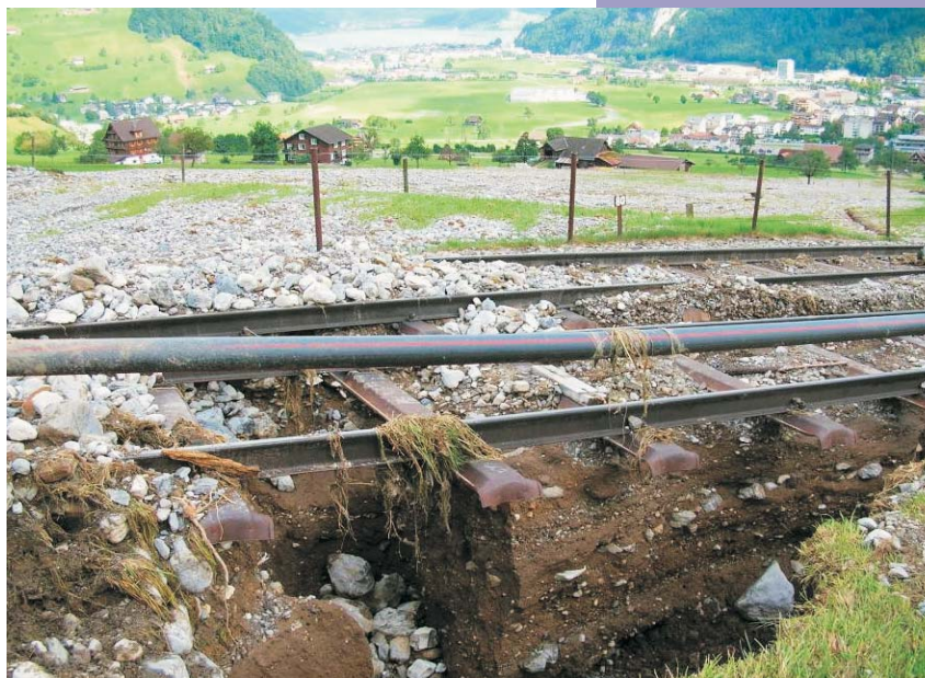
Kniri West: Grossflächige Übersarung und Schäden am Bahntrassee. (Bild oq)
